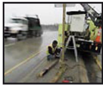
Signalisatie panelen Panneaux de signalisation
